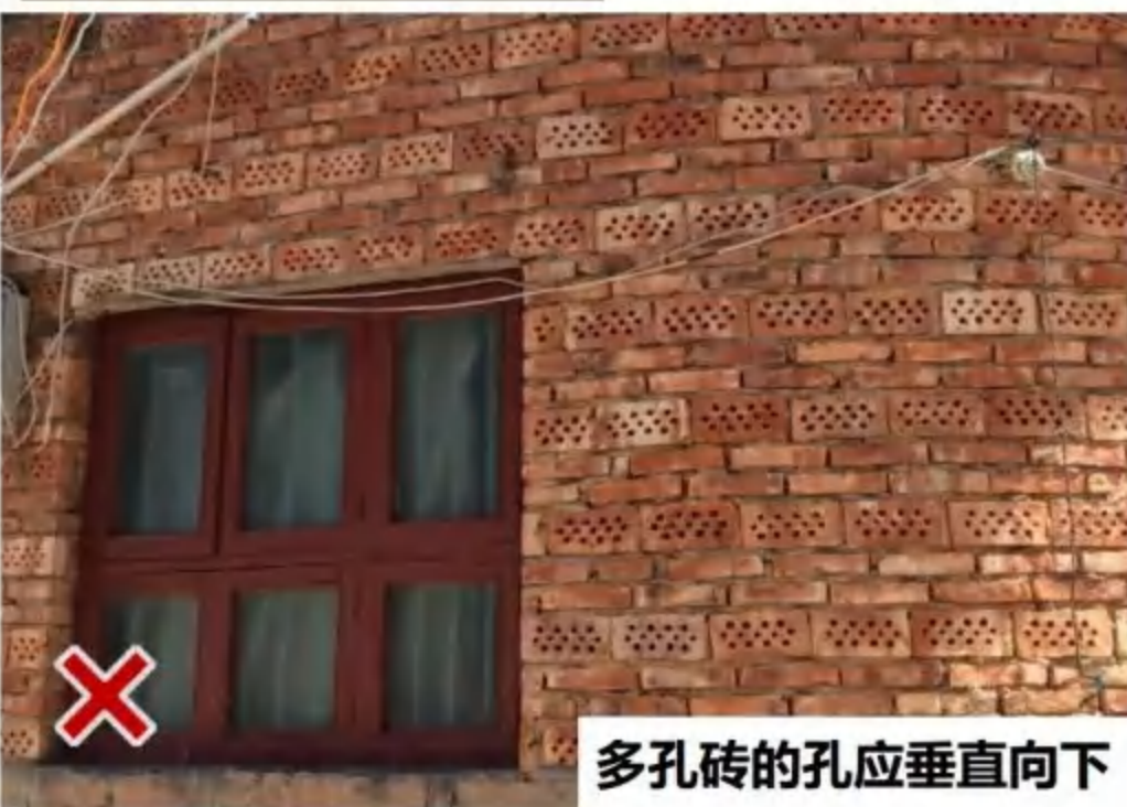
不应采用空斗墙承重
